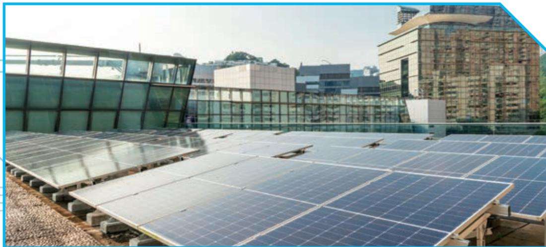
Cyberport expanded solar power system at Cyberport 3. 太陽能發電系統已擴展至數碼港3座。
