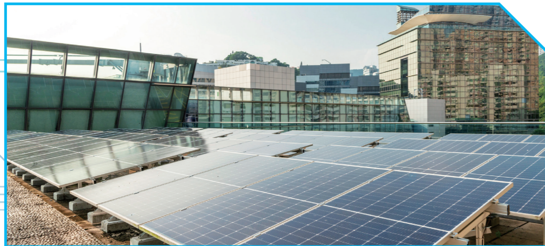
Cyberport expanded solar power system at Cyberport 3. 太阳能发电系统已扩展至数码港3座。
